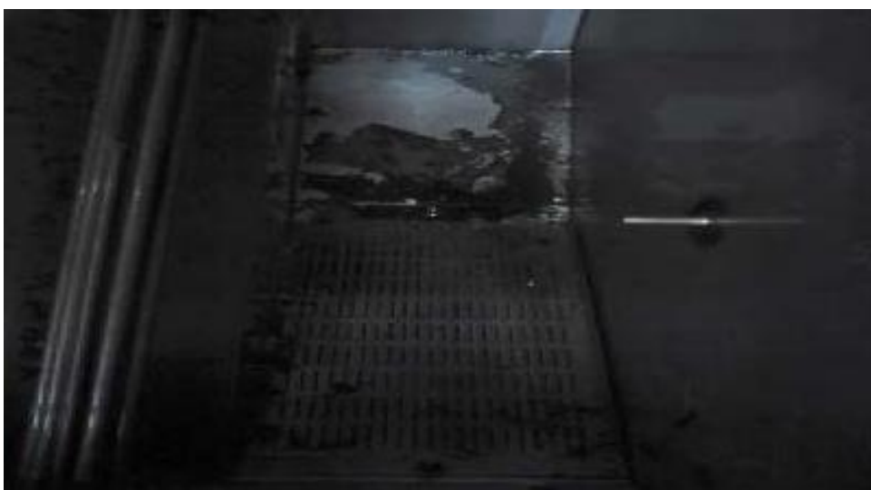
Bilde 2. Sotbelegg på bunnen av tanken i vaskeanlegget etter noen vask.
